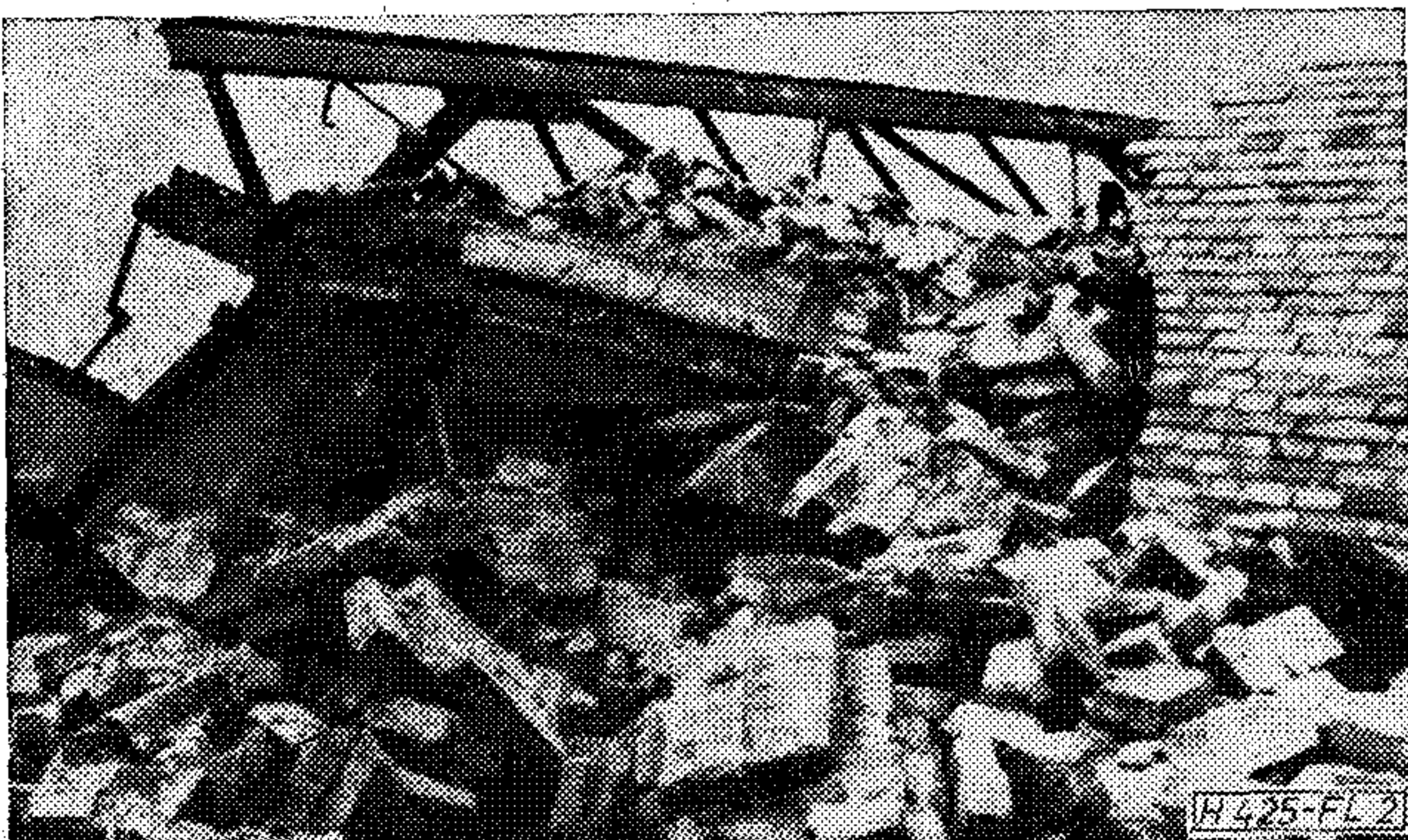
2. ábra. A lakihegyi adóállomás épülete romokban
