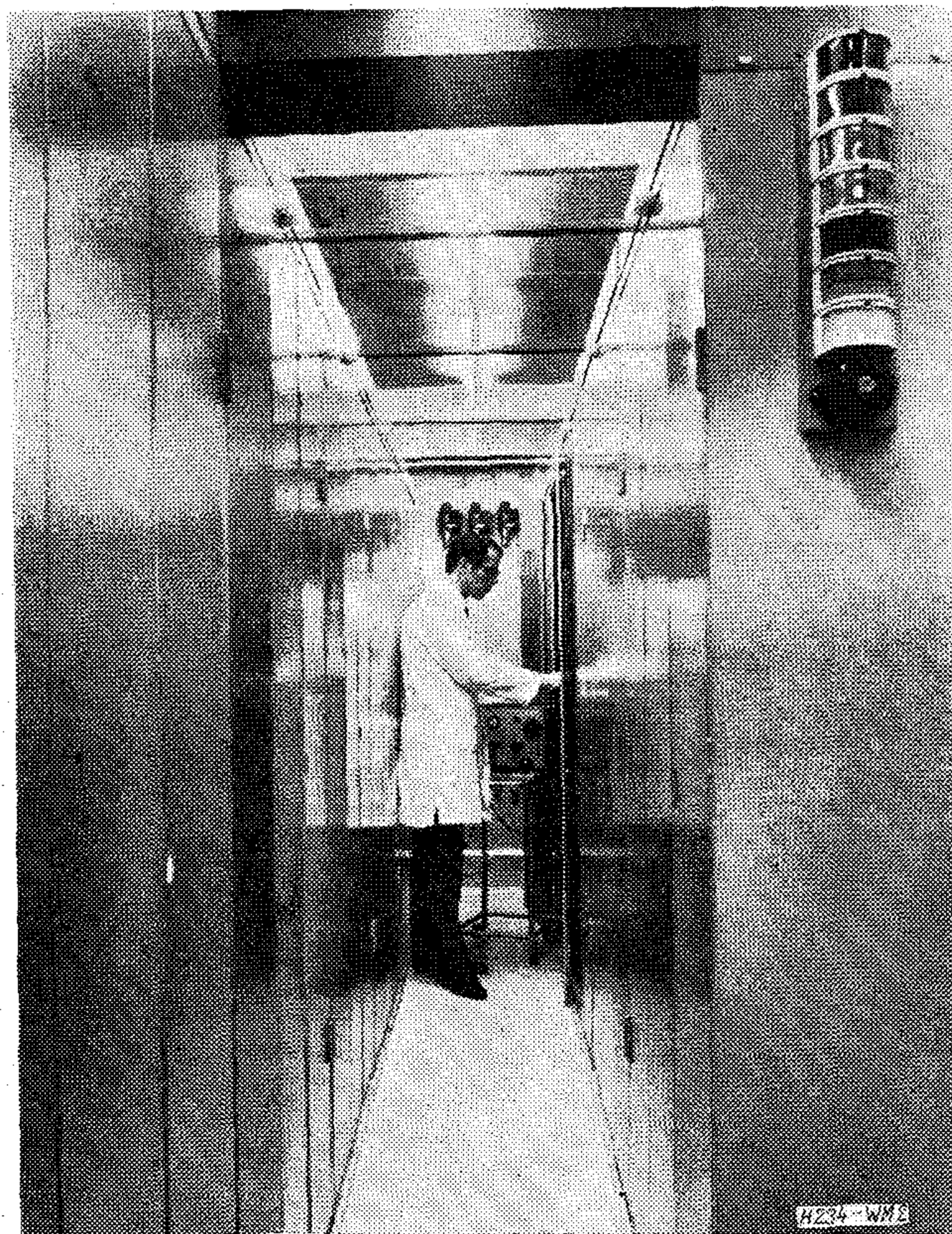
2. ábra. Üzemtér műszaki berendezésekkel
